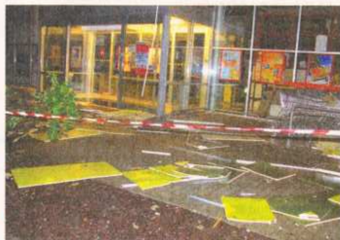
STŘECHA SUPERMARKETU V HRANICÍCH SE ZRŮTILA. Hned tak si Hraničané v obchodním středisku Billa nenakoupí. Od střeďečních záplav je tato velkoprodejna mimo provoz. Téměř polovina její střechy se propadla dovnitř a z přední části budovy opadala většina stropních podhledů. Na horním snímku je zaplavené okolí dálnice u Hranic. Foto: Marcel Mátl, Kateřina Kapková
